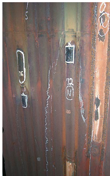
Рис. 6. Ремонтные заплатки и течи с булавочную головку
